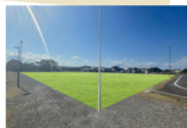
練習用の照明設備
